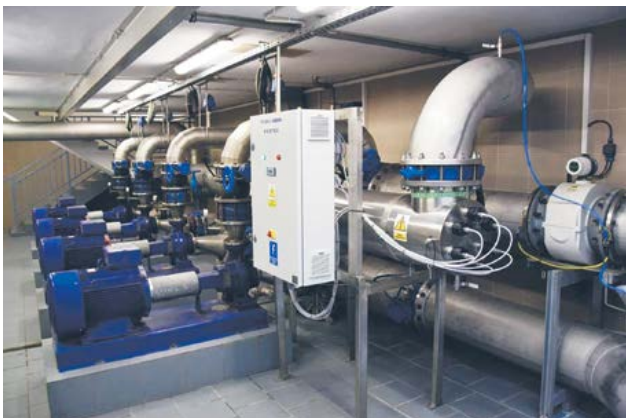
Stacja Uzdatniania Wody Gostkowo.
