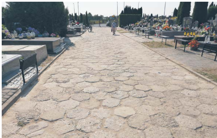
Radna Edyta-Rzeplińska Filipowicz interpelowała w sprawie remontu m.in. głównej alejki cmentarnej prowadzącej od strony bramy znajdującej się przy pętli miejskiej.
