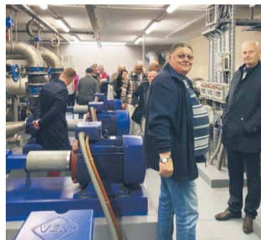
Wizyta w Stacji Uzdatniania Wody.
