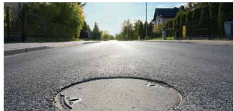
Zapadnięte studzienki kanalizacji deszczowej na ulicy Kwiatowej
