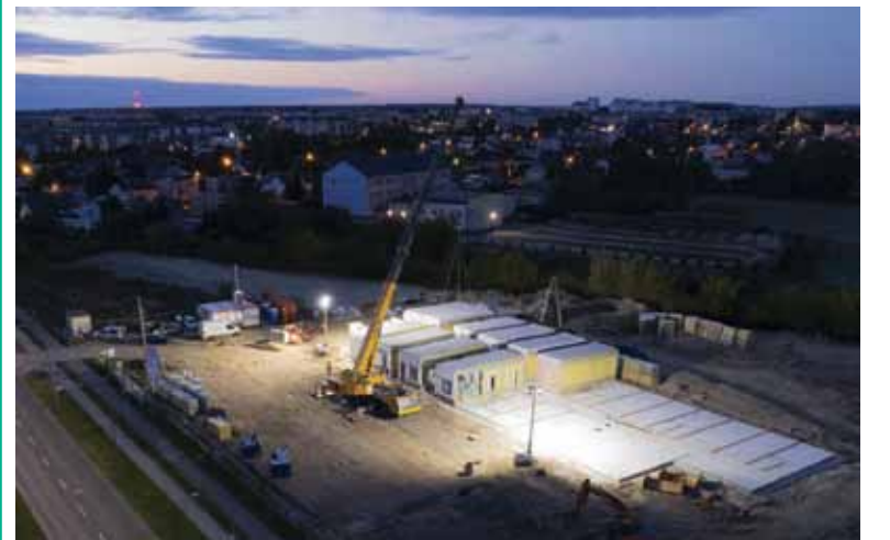
Transport prefabrykanych elementów odbywał się w godzinach nocnych, by zminimalizować niedogodności komunikacyjne na drogach
