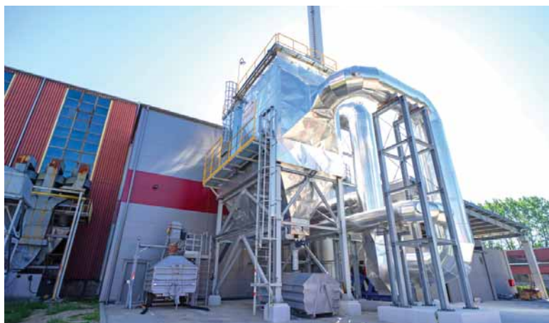
Nowoczesna instalacja na terenie elektrociepłowni (ul. Tysiąclecia).
