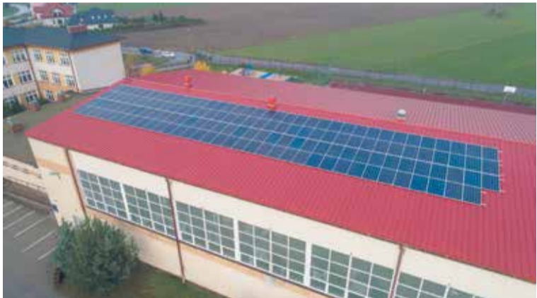
Panele fotowoltaiczne na dachu hali sportowej przy Szkole Podstawowej nr 4.
